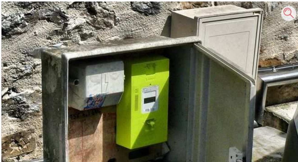
ENEDIS a été obligé de changer le compteur./ Photo DDM
